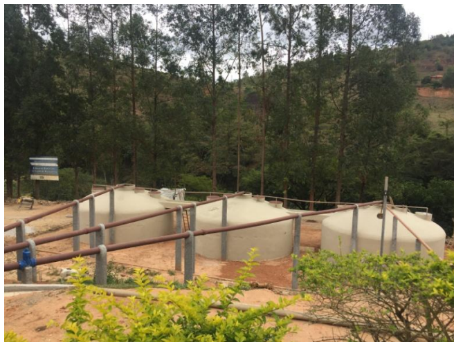
Figura 11 – Detalhe dos reatores recuperados
