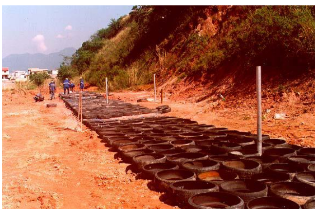
FIGURA 22 – Estágio inicial da construção do muro: posicionamento da 1a camada de pneus
