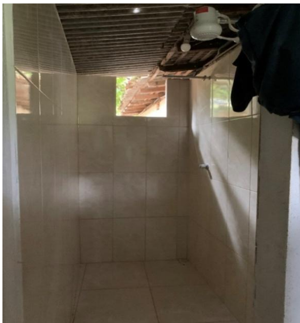
Figura 13 – Instalações sanitárias: chuveiros.
