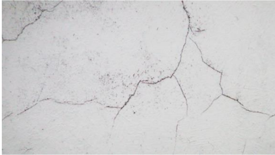
Figura 1. Trincas e Fissuras
