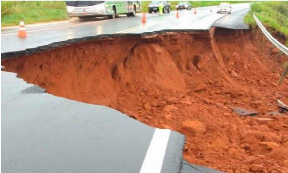
Figura 2: Processo erosivo decorrente da construção de rodovias
