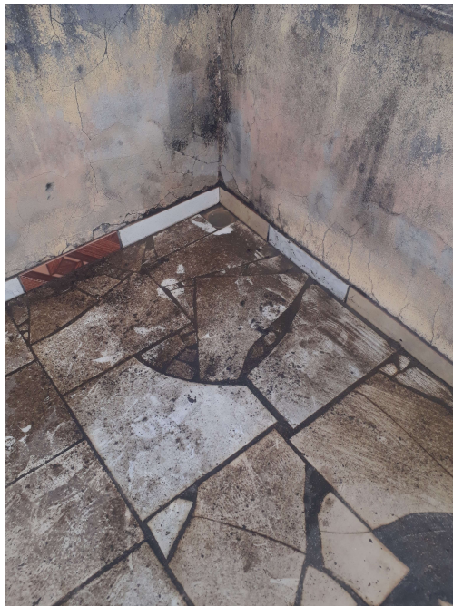
Figura 8: Área do terraço com sinais de infiltração e entupimento
