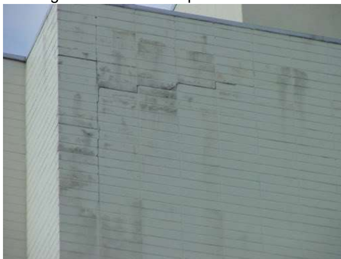
Figura 5: Trincas em placas cerâmicas
