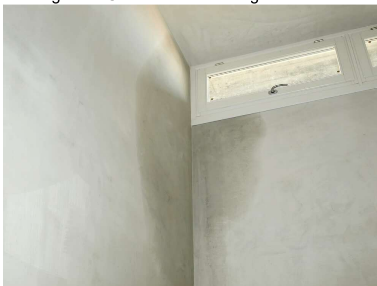
Figura 2: Umidade devido à água da chuva
