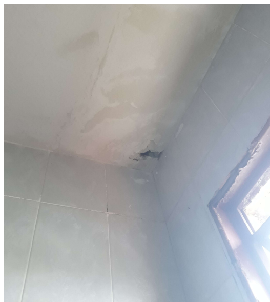
Figura 11: Patologias no interior do apartamento
