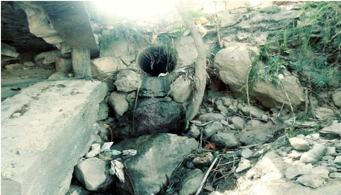
Figura 06 – Esgoto Lançado no Córrego São João.
