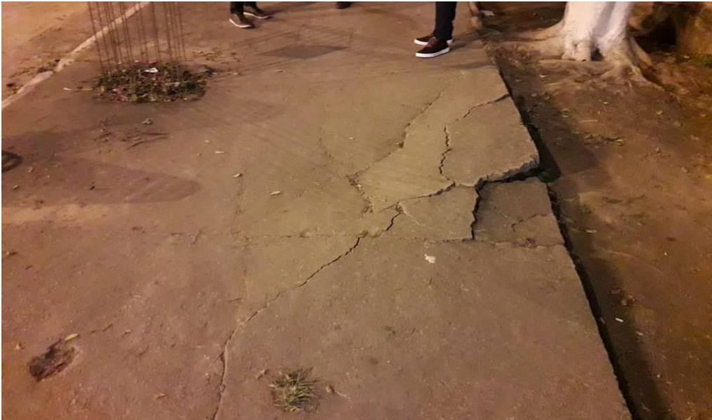
Figura 7 – Calçadas Danificadas por Raízes de Árvores
